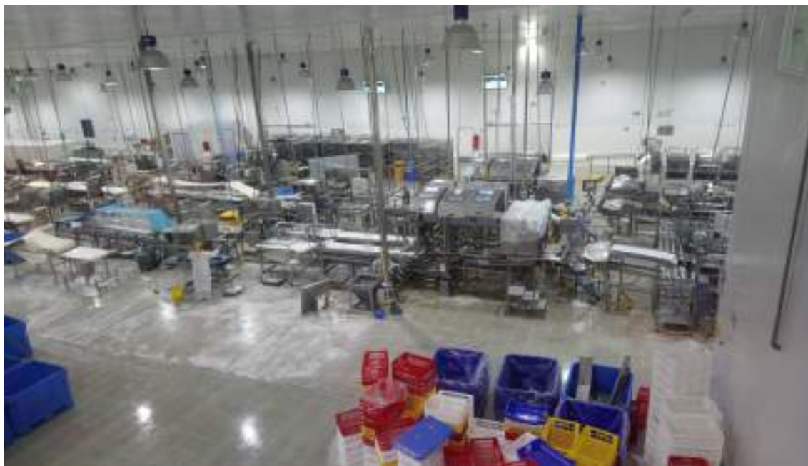
Interior de una planta de proceso. Fuente propia (trabajo en terreno)
